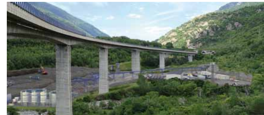
Vista del cantiere del cunicolo esplorativo in fase di scavo e di deposito del materiale di risulta
